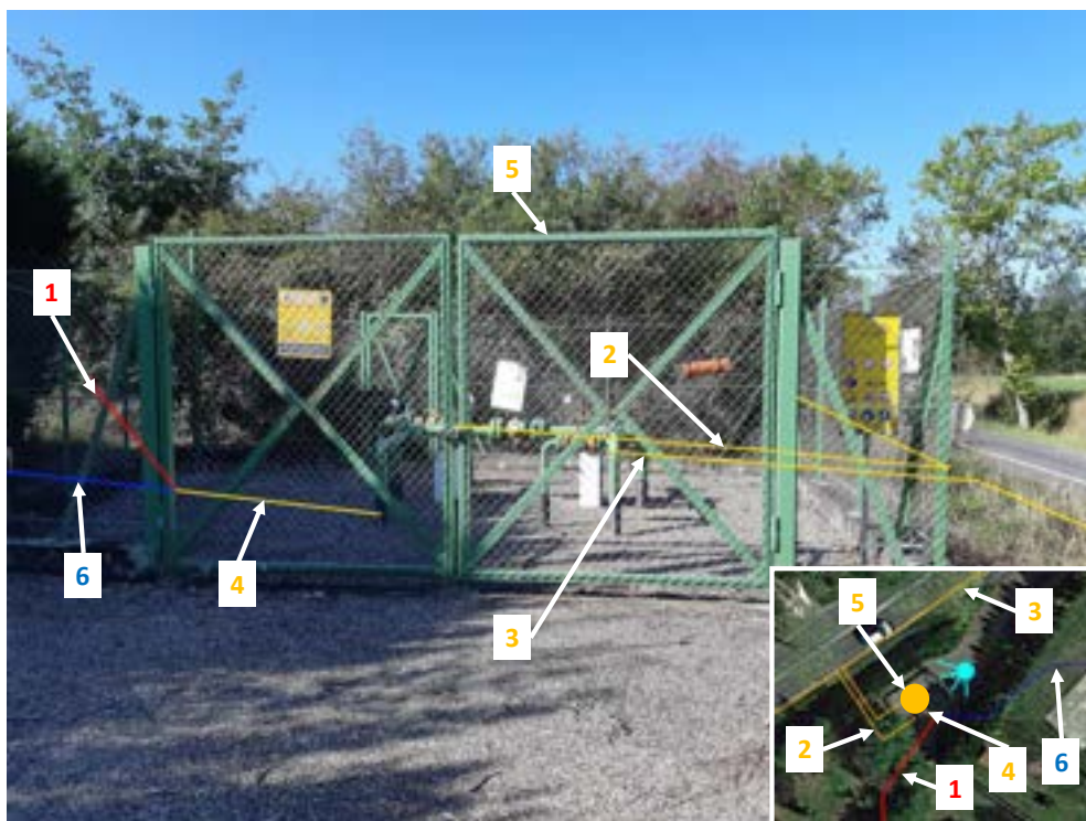
1 : Branchement DN80 GRDF MONTAUBAN ZI PARAGES projeté - 2 : Canalisation DN125 BOURRET – MONTAUBAN ZI PARAGES à mettre à l'arrêt définitif d'exploitation - 3 : Canalisation DN100/125/150 MONTAUBAN ZI PARAGES – MONTAUBAN STATION à mettre à l'arrêt définitif d'exploitation - 4 : Branchement DN80 GRDF MONTAUBAN ZI PARAGES à mettre à l'arrêt définitif d'exploitation - 5 : Poste de Sectionnement de MONTAUBAN ZI PARAGES à mettre à l'arrêt définitif d'exploitation - 6 : Branchement DN80 GRDF MONTAUBAN ZI PARAGES existant
